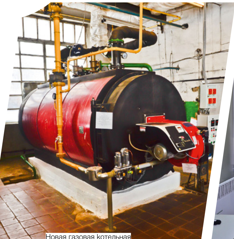
Новая газовая котельная
